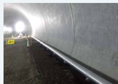
トンネル消火配管 ポリエチレン管
