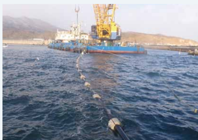
海水取水ポリエチレン管
